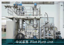
中试装置 Pilot Plant Unit
